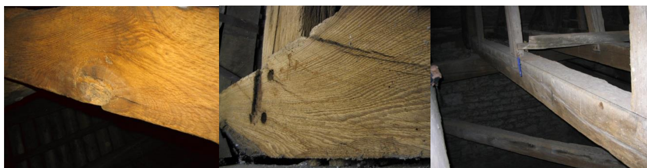
Figure 2: nœud, direction des fibres et fissure
