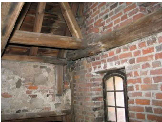
fot.5. Korozja biologiczna elementów drewnianych w obszarach styku drewna z miejscowo zawilgoconymi ścianami szczytowymi.
