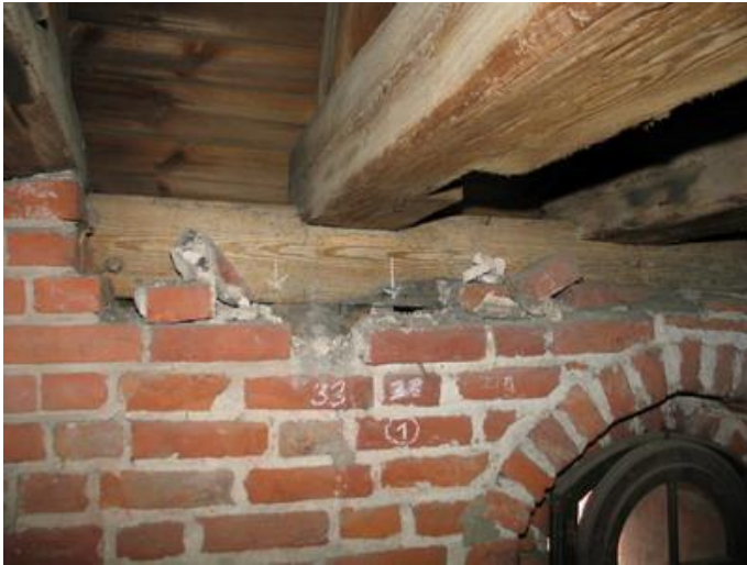
fot.3. Odkrywka w ścianie PN przy więźarze nr 33. Strzałki wskazują fragment słupka, pierwotnej konstrukcji szkieletowej, zachowany za obmurówką z cegły.
