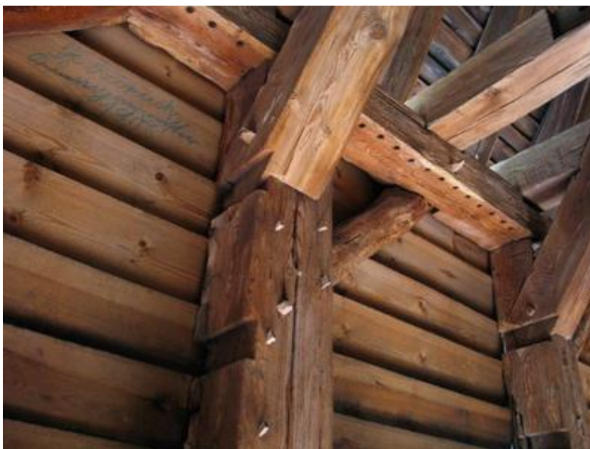
fot.1 Konstrukcja wtórnie oszalowana z wymienionymi elementami, widoczne wbite kołeczki oraz puste gniazda połączeń ciesielskich
