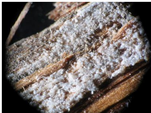
fot.10. Silne wysolenia na powierzchni drewna
