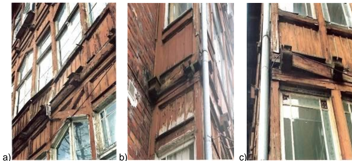
Rys. 3. Fragmenty werand, stan z marca 2003r. a) Bardzo silnie zdeformowany fragment ściany I p. Zniszczone kroksztyny: b) ściana północna , c) ściana południowa.
