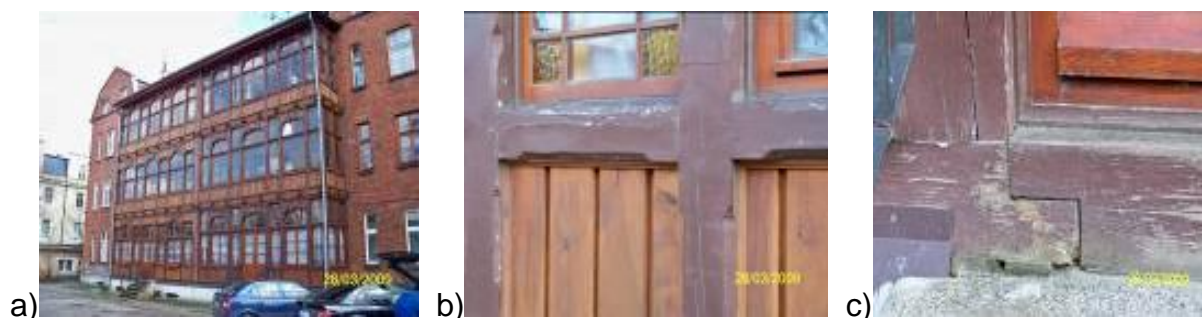
Rys.5. Stan obiektu w trzy lata po przeprowadzeniu prac remontowych. a) ogólny widok od płd.- zach. b) rygiel podokienny parteru z łuszczącą się powłoką malarską c) fragment podwaliny w sąsiedztwie drzwi wejściowych.
